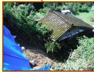
R4 国分川原地区（霧島市） がけ崩れ災害
