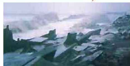
台風による海岸護岸の被災(昭和58年 静岡市清水区蛇塚)
