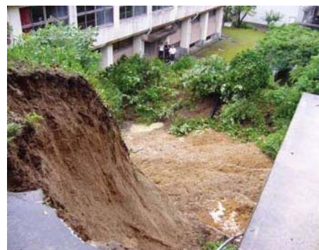
土砂流出状況
