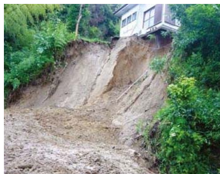
土砂流出状況
