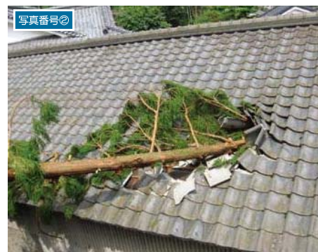
人家被災状況
