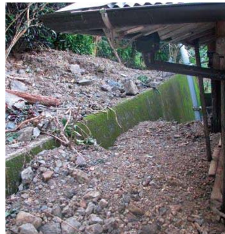
人家被災状況
