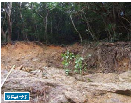
斜面崩壊状況
