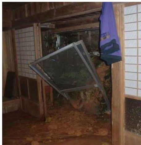
人家被災状況
