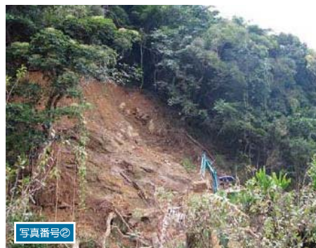
斜面崩壊状況
