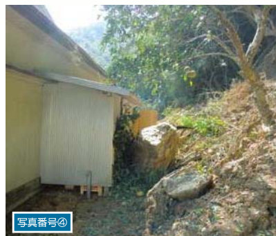
人家被災状況
