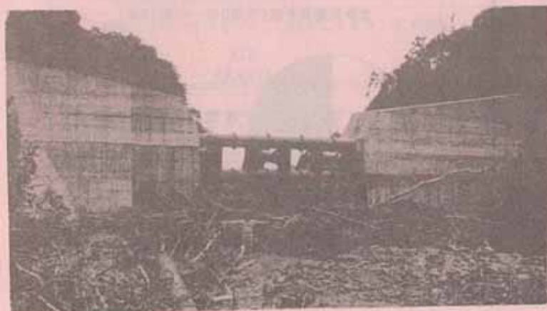
上流約30mの位置から下流に向かっての土石流堆積状況
