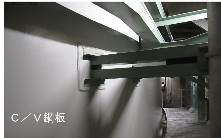
配管サポート
