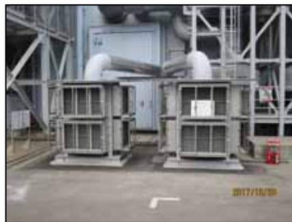
フィルタコンテナユニット(2基 / DG)
