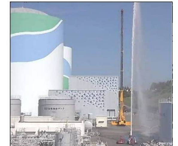
◇放水砲による放水
