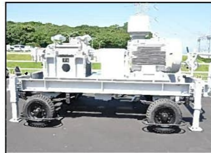
可搬型電動低圧注入ポンプ
