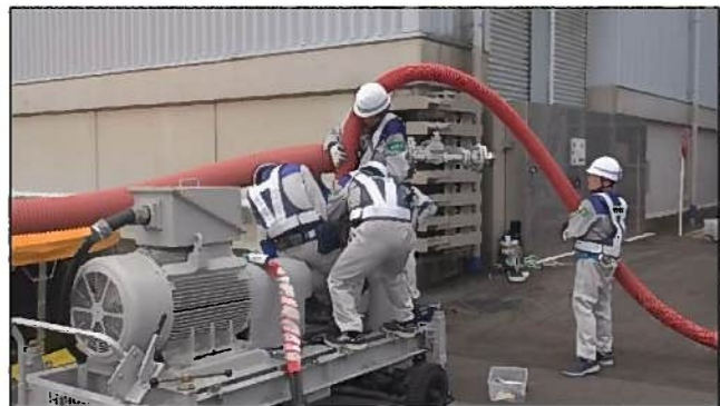
◇可搬型電動低圧注入ポンプの設置
