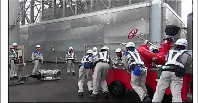
◇放水砲の設置
