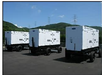
直流電源用発電機
