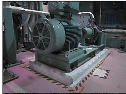
常設電動注入ポンプ
