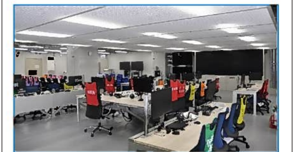
緊急時対策棟（指揮所）【室内】
