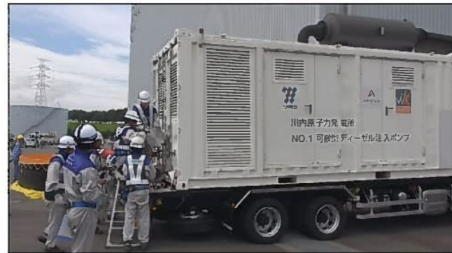
◇可搬型ディーゼル注入ポンプの設置
