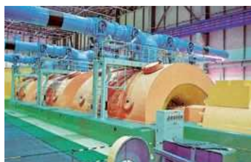
タービン・発電機
