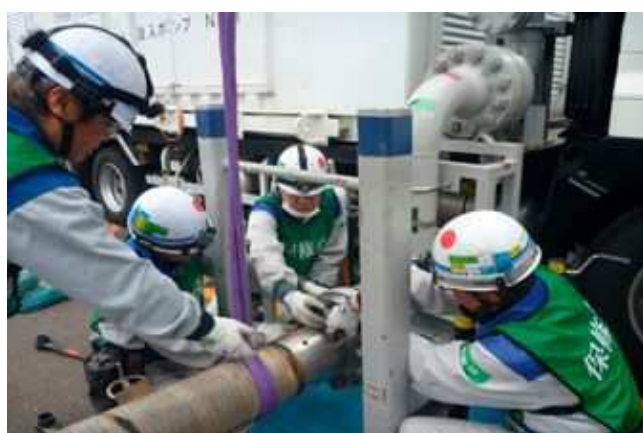
事故収束訓練（発電所内）
