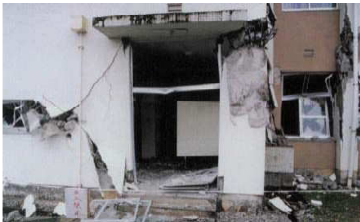
写真8 地震被害（平成9年薩摩地方を震源とする地震（震度6弱））
