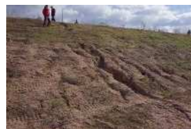
堤防(法面の浸食)
