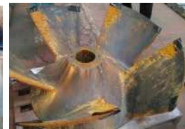
排水機場(羽根車の劣化)
