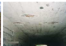
樋門・樋管(鉄筋の露出・腐食)
