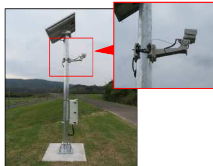
簡易型河川監視カメラ
