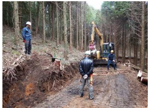
森林作業道作設技術研修
