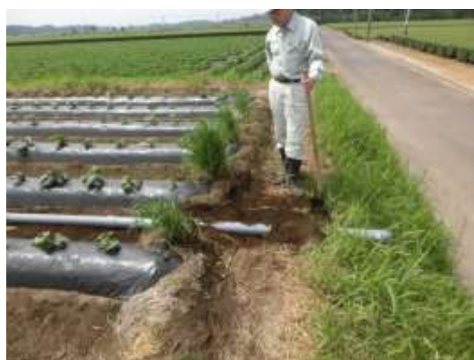
図3 塩ビパイプでほ場外に排水する例
