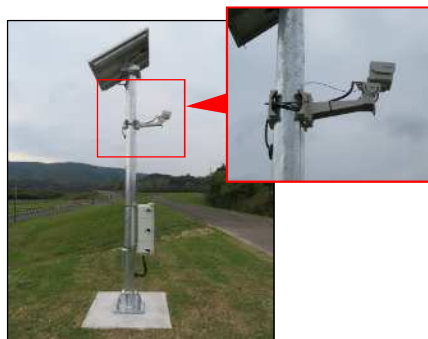
簡易型河川監視カメラ
