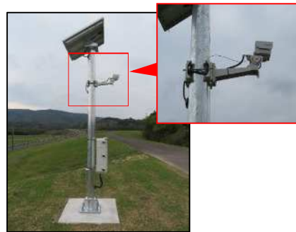
簡易型河川監視カメラ
