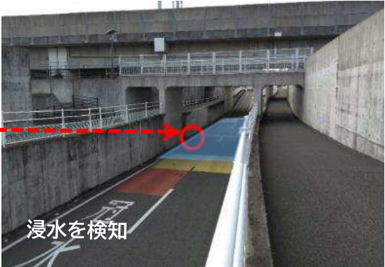
＜浸水センサ設置状況＞
