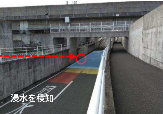
<浸水センサ設置状況>
