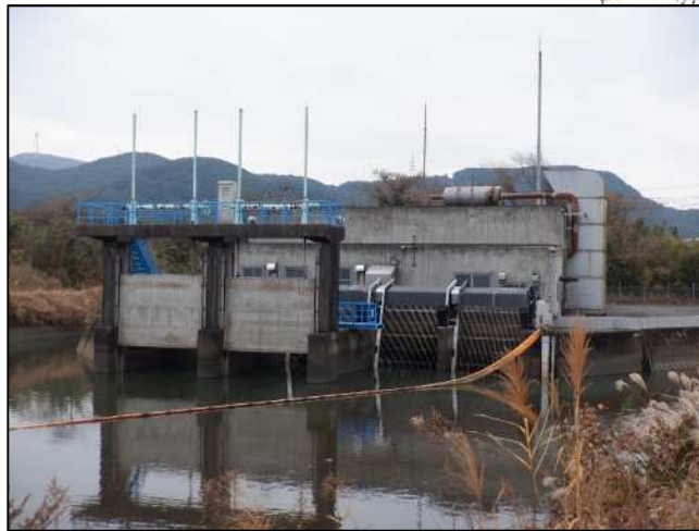
湯島排水機場
