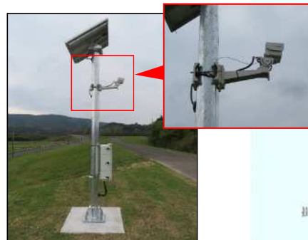
簡易型河川監視カメラ
