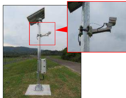
簡易型河川監視カメラ
