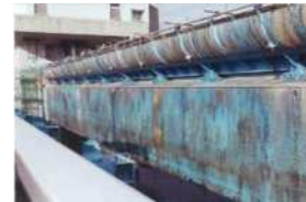
水門(ゲート塗装の劣化)
