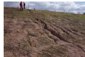
堤防(法面の浸食)
