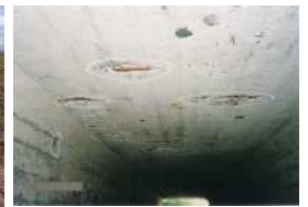
樋門・樋管(鉄筋の露出・腐食)
