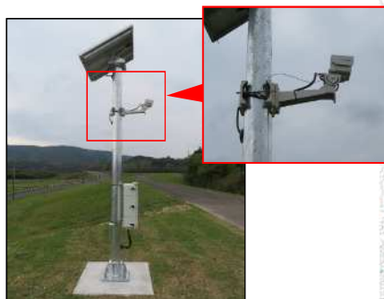
簡易型河川監視カメラ
