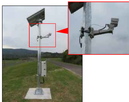
簡易型河川監視カメラ
