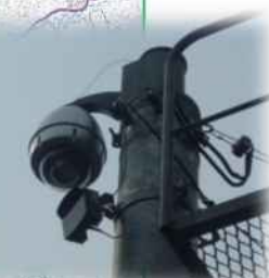
防災用監視カメラ
