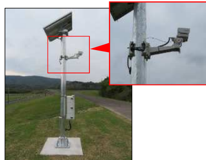
簡易型河川監視カメラ
