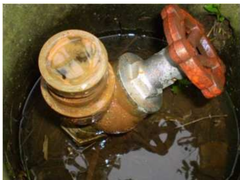
【※①給水栓からの漏水※】
