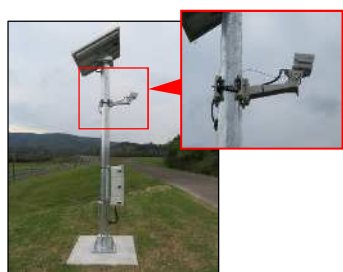
簡易型河川監視カメラ
