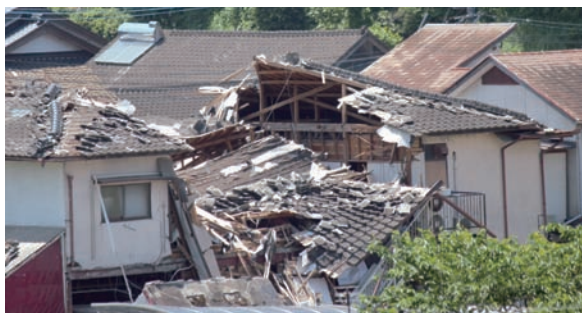
倒壊した家屋
