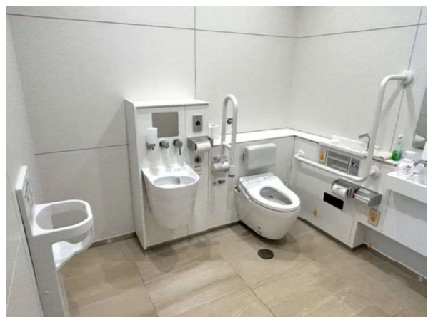
車いす対応トイレ
