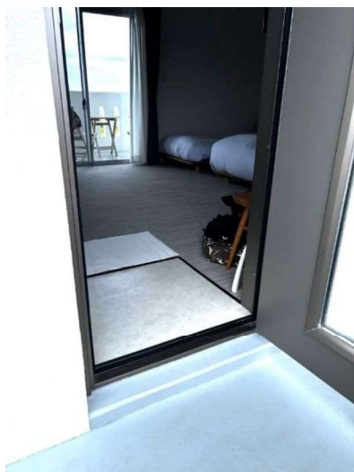
客室入口の段差
