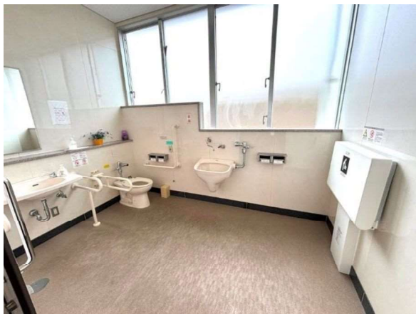
待合所内の車いす対応トイレ
